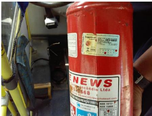
Extintor validade recarga 1 ano vencida;
